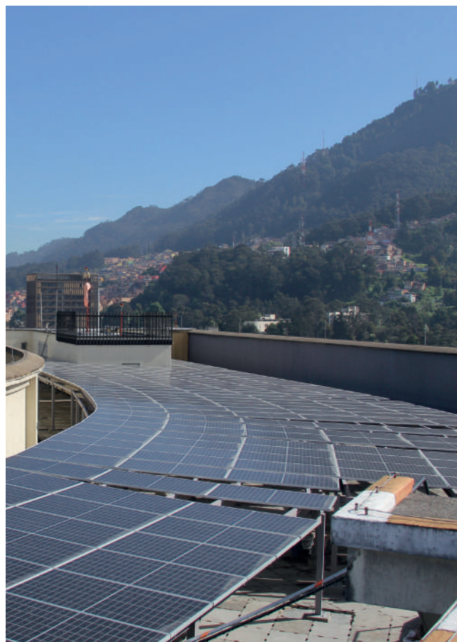
Paneles solares Dirección General, Bogotá.
